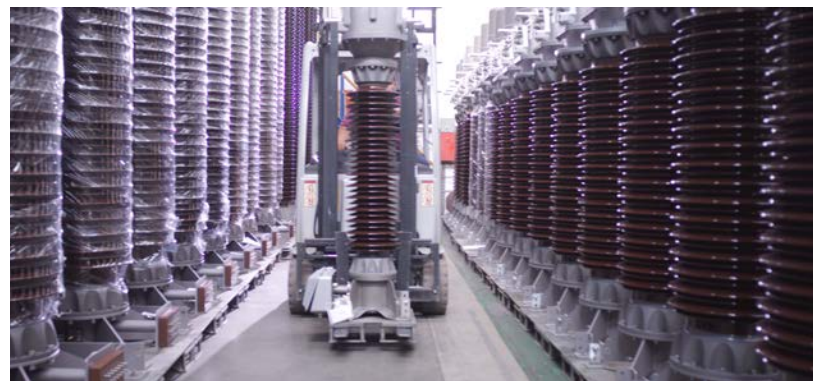
Iskorak u proizvodnom asortimanu KONČAR - Mjernih transformatora isporukom transformatora za vlastito napajanje trafostanica naponskog nivoa 525 kV i snage 250 kVA instalirani u sustav tvrtke Dominion Energy u SAD-u
