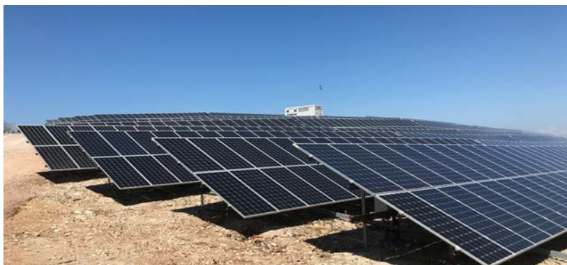
Puštanje u rad trenutno najveće sunčane elektrane u Hrvatskoj, SE Vis - ključni elementi elektrane razvijeni i proizvedeni u KONČARU
