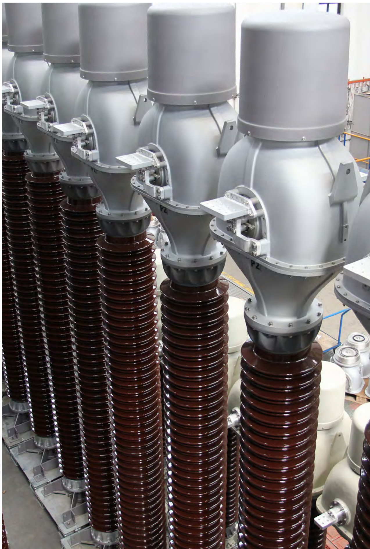
Strujni transformatori 525 kV
