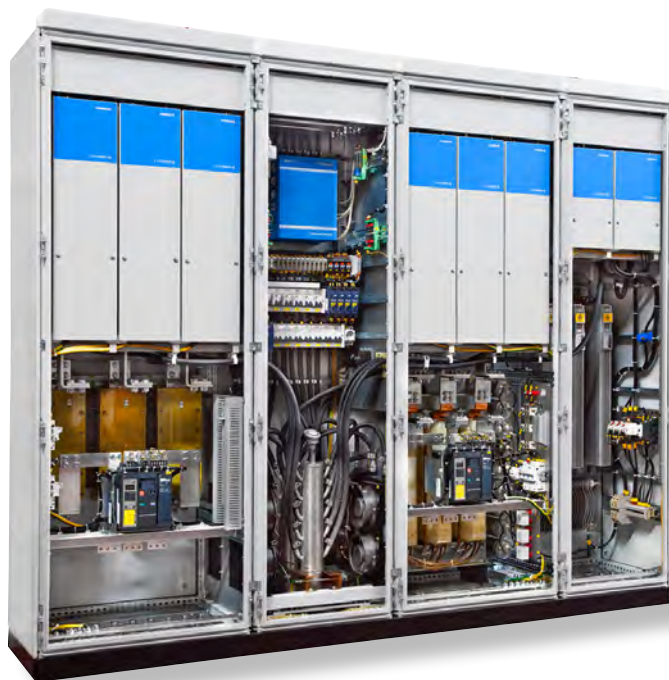
Statički pretvarač frekvencije KONvert W1500, vjetroelektrana u Hrvatskoj
