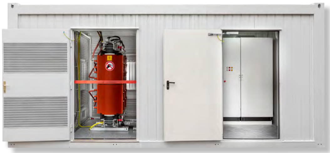
KonSol pretvarač za sunčanu elektranu
