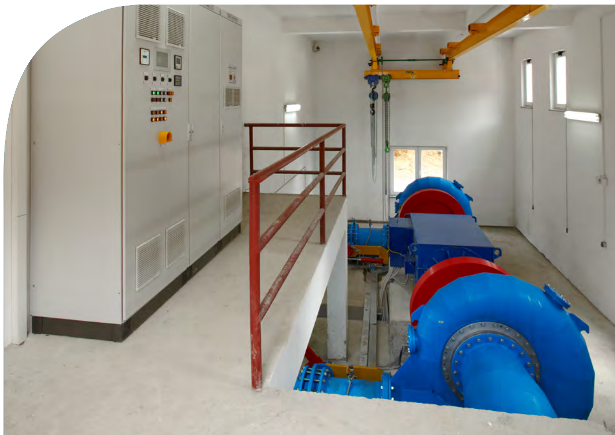
Mala hidroelektrana u Bosni i Hercegovini
