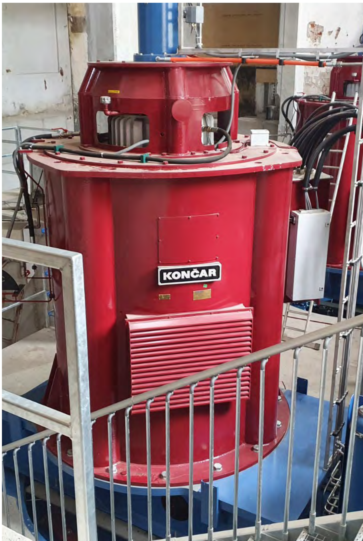
Novi kompakt generator za malu hidroelektranu Haunoldmühle u Austriji
