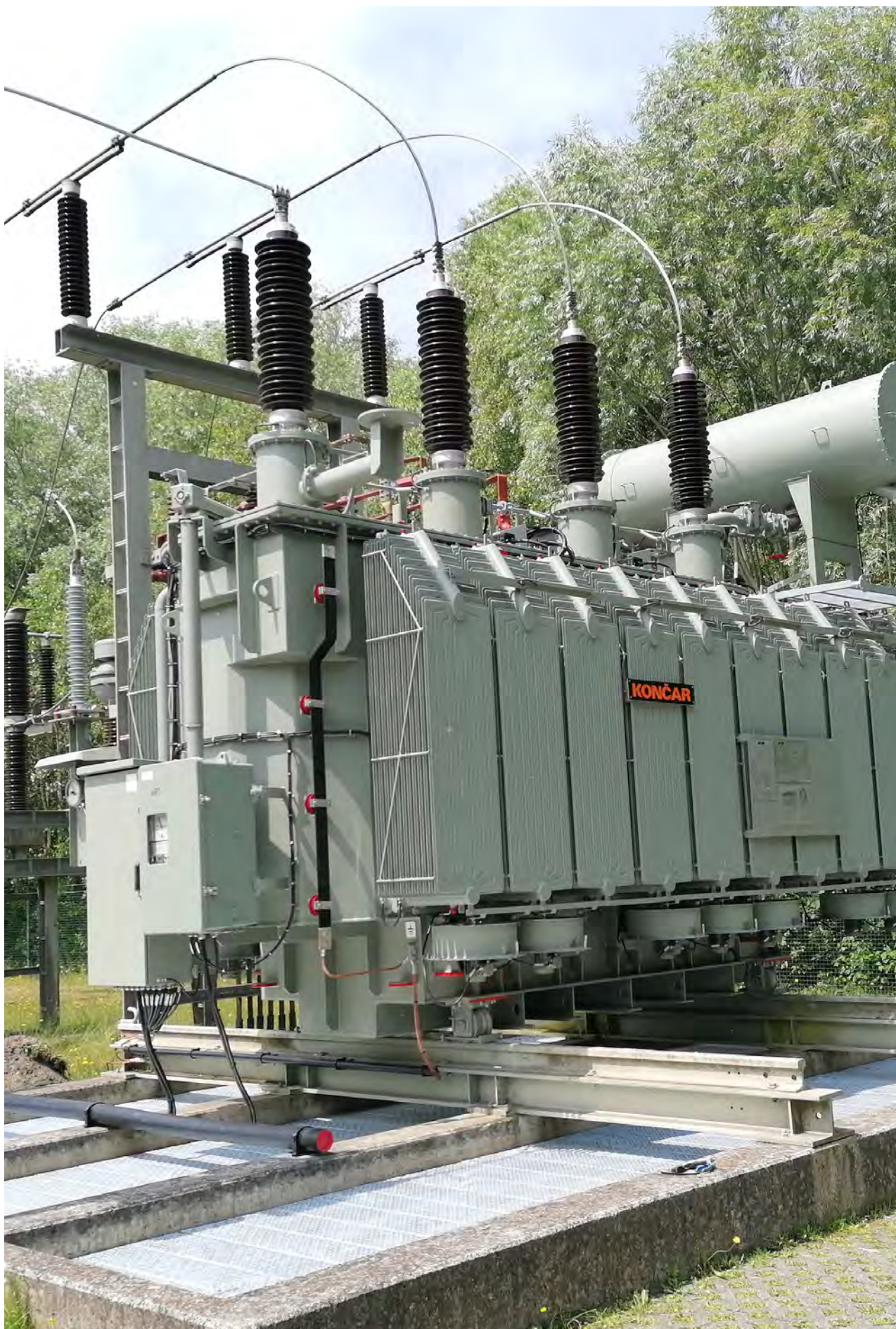
Trofazni uljni energetska transformator nazivne snage 40 MVA
