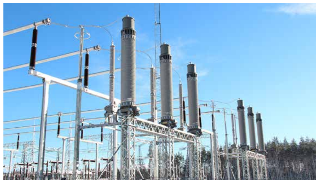
KONČAREVI naponski transformatori velike snage 362 kV
