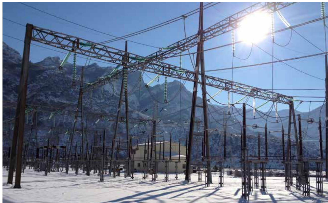
Rasklopno postrojenje Koman u Albaniji koje je KONČAR u potpunosti rekonstruirao
