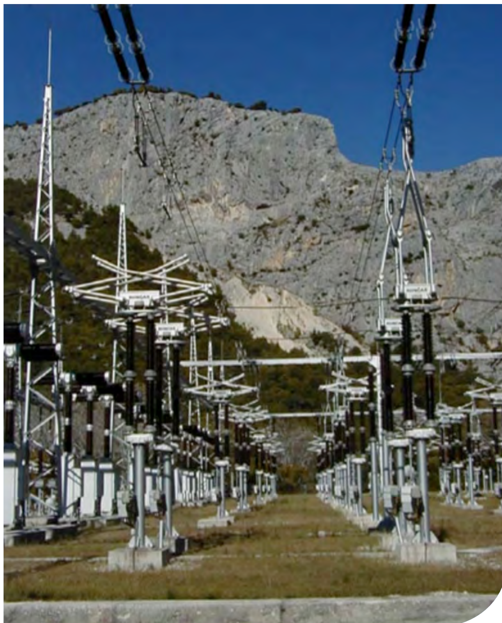
Slika 6. Pantografski rastavljači serije PD, 245 kV ugrađeni u postrojenje HE Zakučac, Hrvatska
